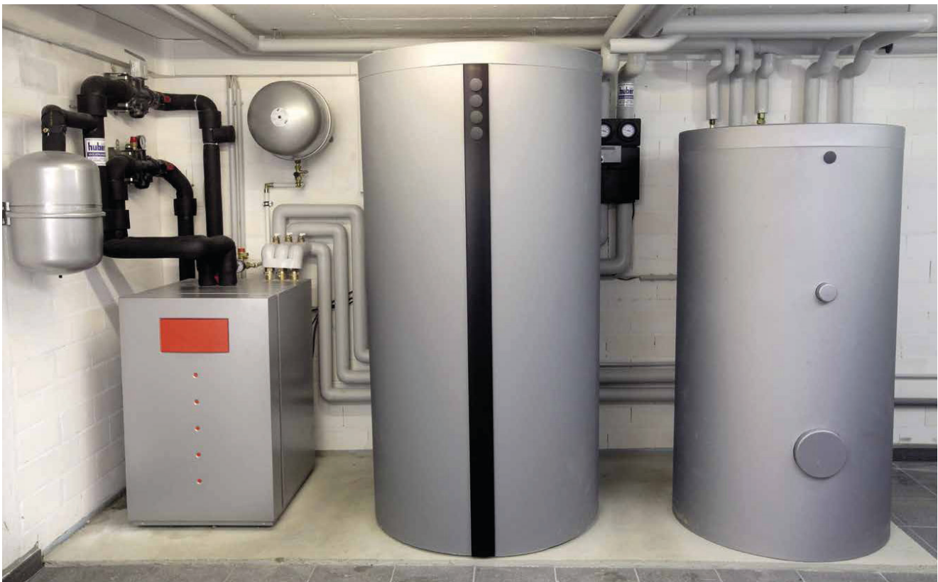
Abb. 121: Wärmepumpe mit Trinkwarmwasserspeicher.
